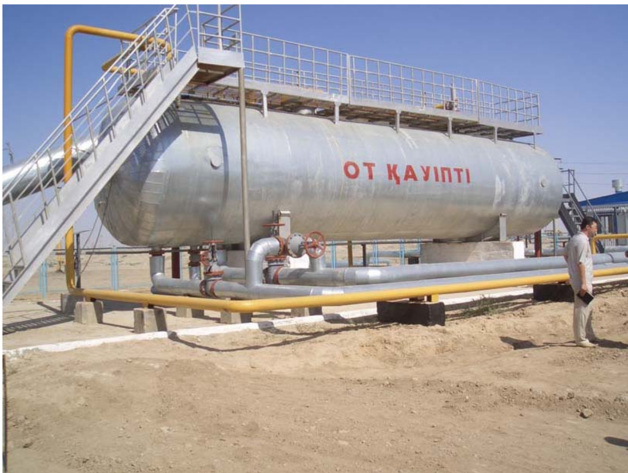
Месторождение Узень. НГДУ 3 Групповая установка 65. Трехфазная сепарация.
