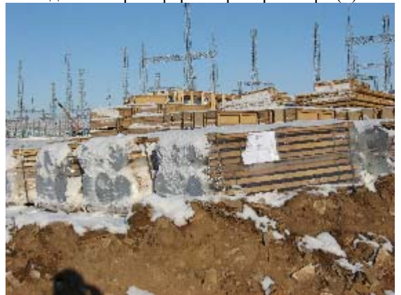
Фото 64. Навесное оборудование для разъединителей 500 кВ (2)
