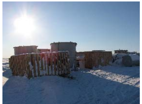
Фото 60. Навесное оборудование для автотрансформатора и реактора (1)
