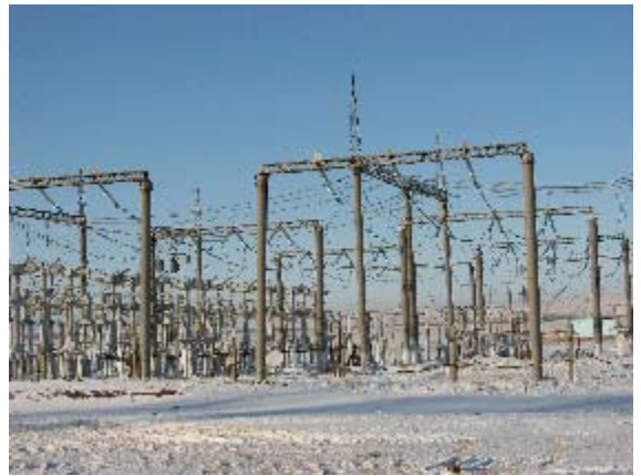
Фото 2. Действующая станция АО «КЕГОС» (2)
