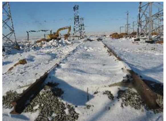
Фото 8. Продольные пути перекачки (2)
