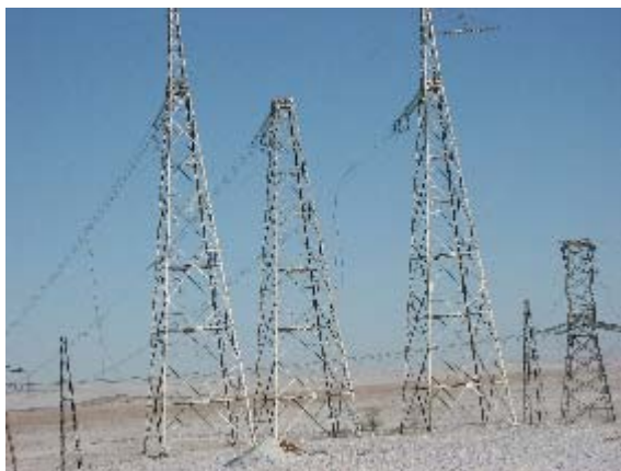
Фото 24. ЛЭП (подстанция «Ульке»)
