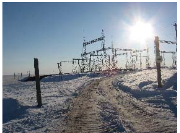
Фото 6. Въезд на подстанцию «Ульке»
